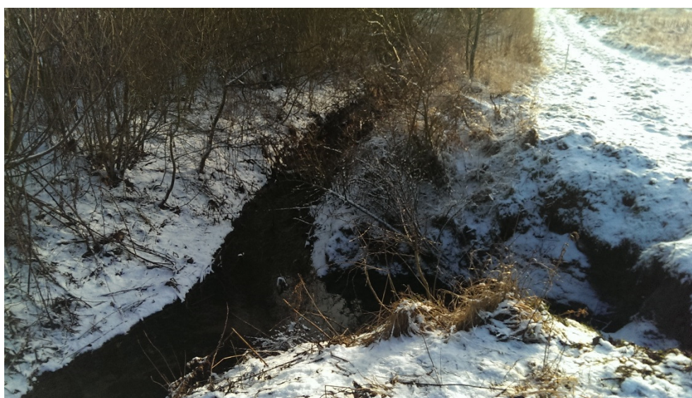
Figur 9 Indløb til Ø65 cm ledning (mod højre i billedet). Ved kraftige hændelser kan røret ikke følge med og vandet stuver op og løber ud på terræn.
