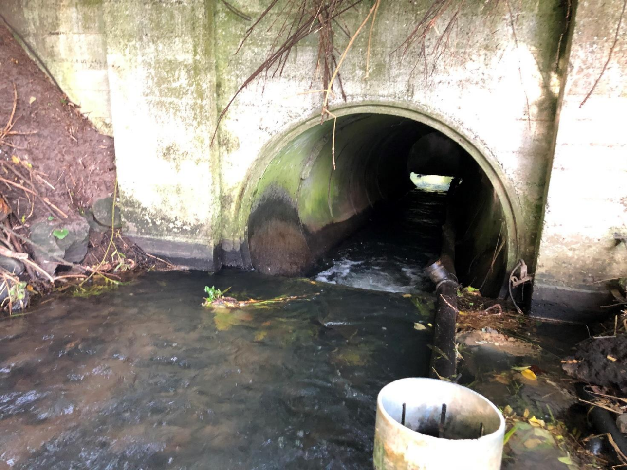
Figur 3-1. Første styrt før indløbet i rørføringen. Der er placeret et plastrør for at hjælpe ålens vandring i vandløbet.
