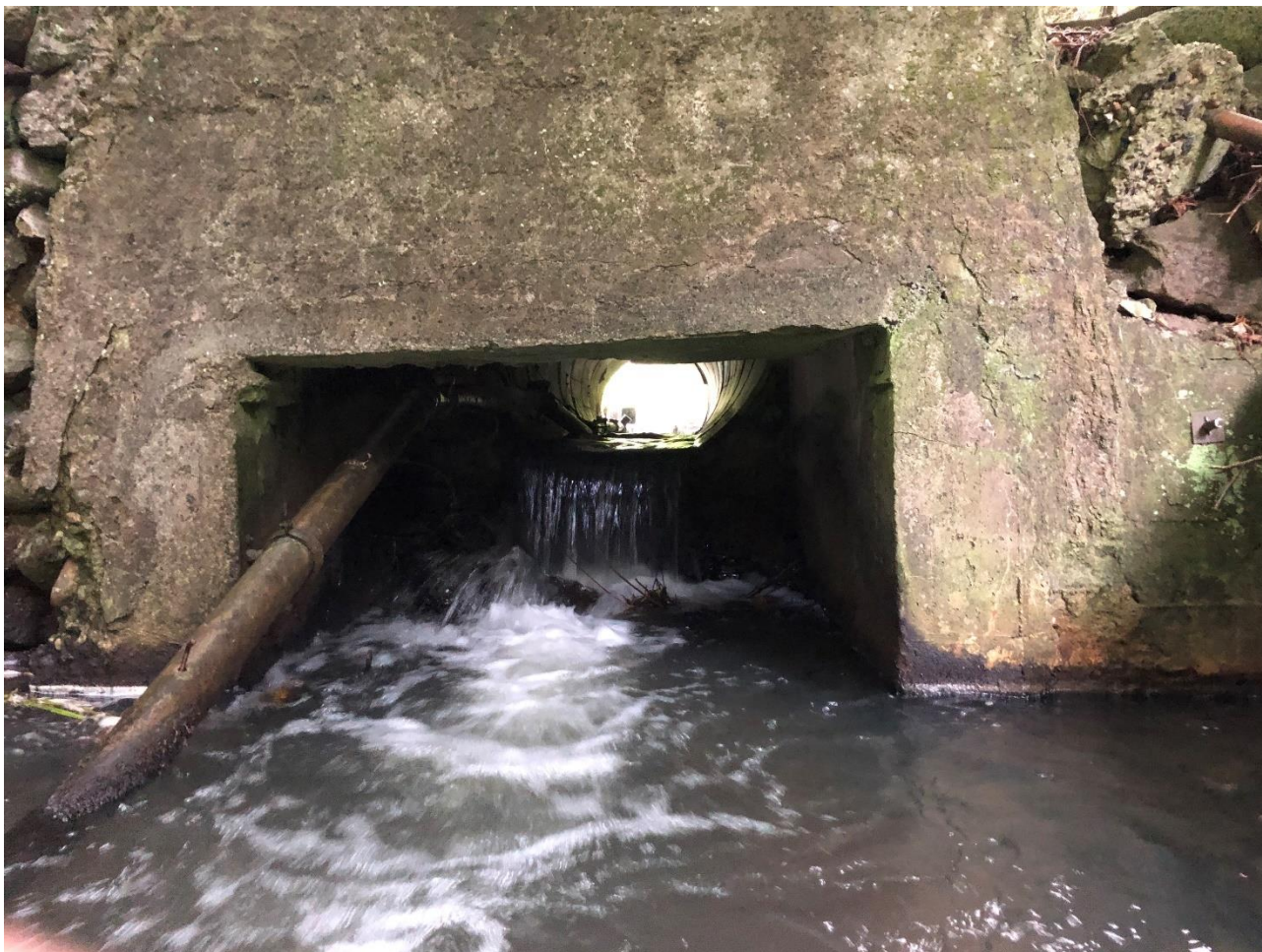
Figur 3-2. Det andet styrt under betonbygværket.
