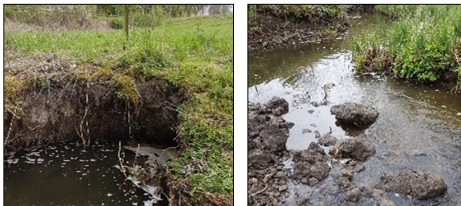
Figur 13: Erosionsskader på brinkanlæg (venstre), der har forårsaget store forekomster af afgravet lerjord, der dækker bunden af grus (højre).
