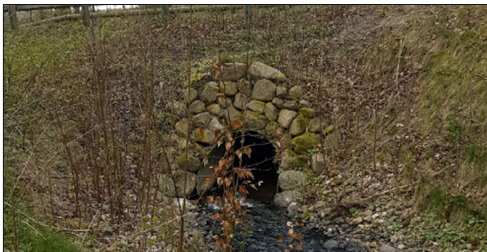
Figur 12: Indløb under Margårdsvej i st. 5.104 m.
