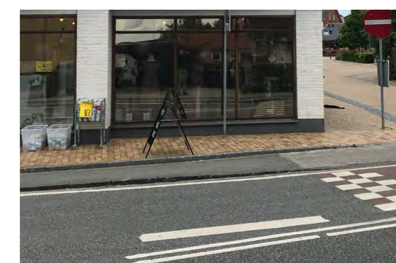
Eksisterende; Gulige teglklinter på fortovet
